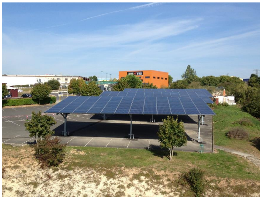
Exemple d'un projet en ombrières photovoltaïques
